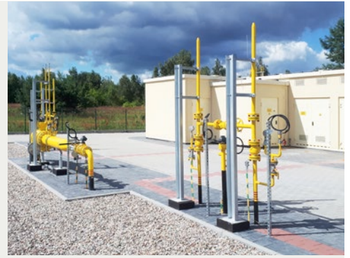
The new Gorzów II reduction and metering station Photo: © Polska Spółka Gazownictwa
